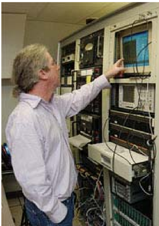
Sistema de detección y alerta
